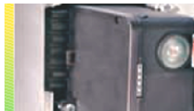
Automatika se zapalovacím transformátorem
