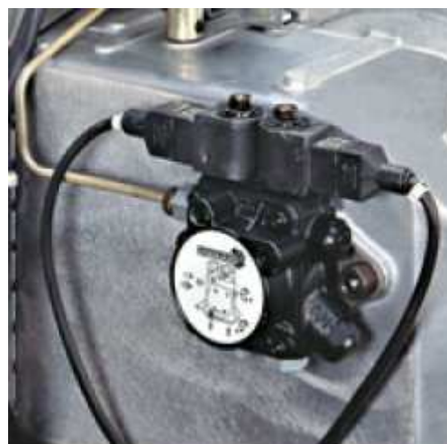
Příklad hydraulického obvodu na hořáku RL 32 BLU
