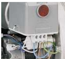
Automatika se zapalovacím transformátorem
